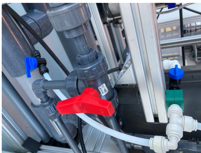
Figuur 85: Reduceerkraan toegevoegd (linkerkant) aan de afvoer bij een douchekraan om relatief lagere weerstand bij de monsternamekraan (rechterkant) te verhelpen.
