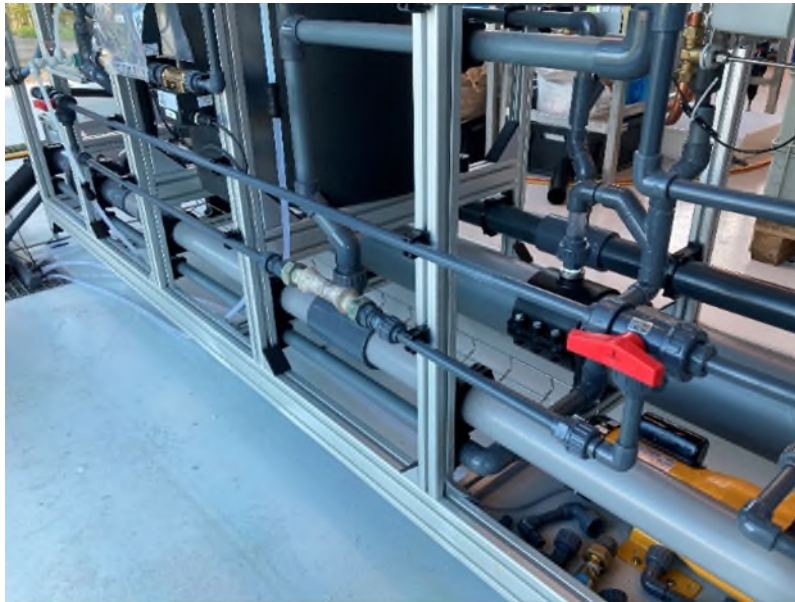
Figuur 77: Aparte leiding voor loden stuk met behulp van twee driewegkranen (rode kranen).
