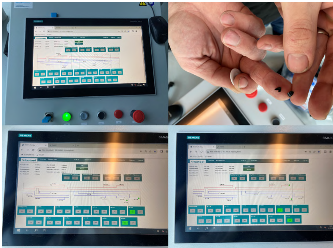
Figuur 80: (Linksboven) De volumestroom gemeten door de lokale flowmeter van de keukenkraan is \sim 10 l/min terwijl er geen stroming in het systeem überhaupt is. (Rechtsboven) Aanwezigheid van vervuiling bij een reduceerplaatje die tot verlaagde volumestromen leidt. (Onder) Te hoge volumestromen bij binaire kranen wegens afwezigheid van reduceerplaatjes.
